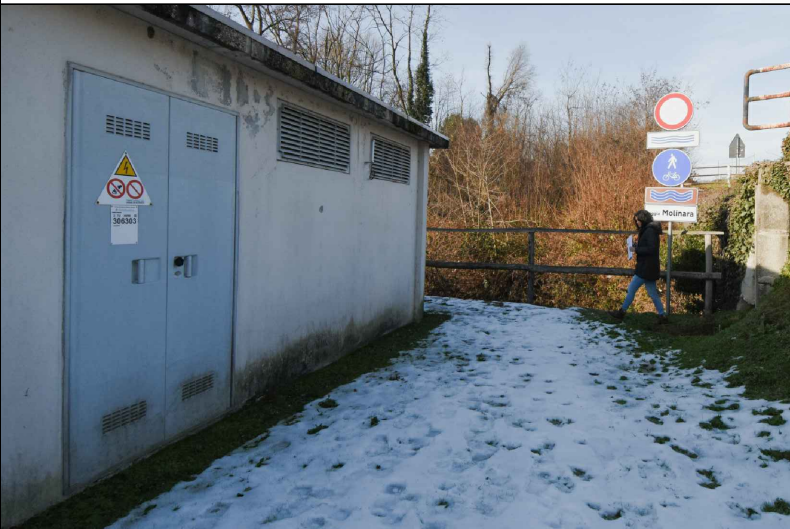
Cabina Enel esistente
